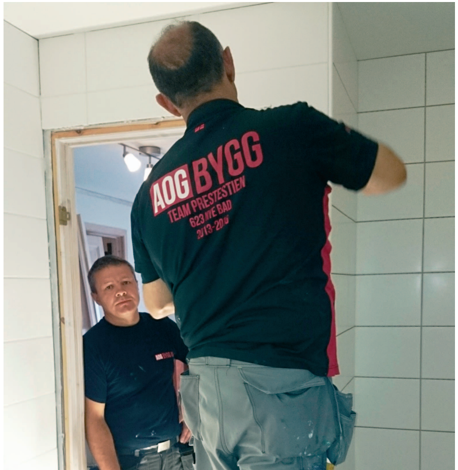
Rosen Malinov Koynarev (t.v.) og Cemal Barcin totalrenoverer et bad på Sørås.
